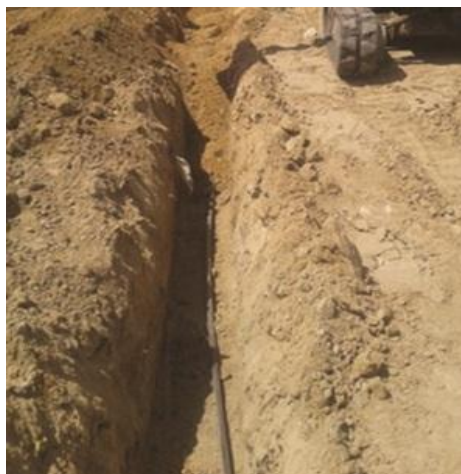
zdj. 3 przyłącze energetyczne
